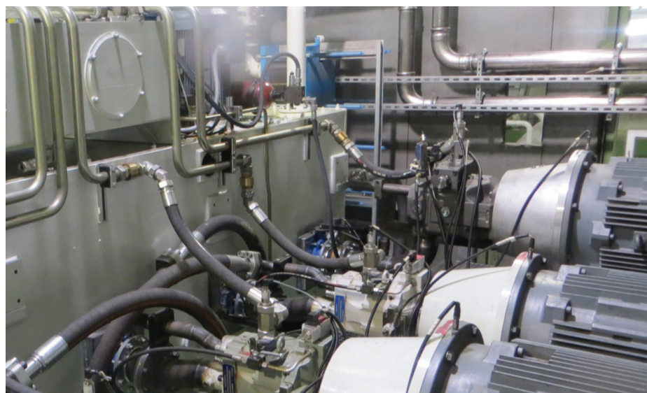
Pompes de puissance dans l'extrusion d'aluminium.
