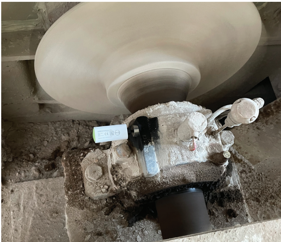
La cimenterie opère avec d'énormes ventilateurs (des exhausteurs), jusqu'à 1 megaWatts de puissance, chargés d'extraire les gaz de combustion des fours de la cimenterie.
