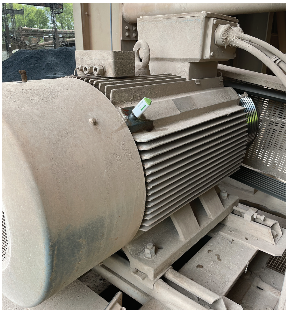
Dans le cadre d'un projet pilote, deux ventilateurs extracteurs ont été sélectionnés, puis dotés de plusieurs capteurs en différents emplacements.
