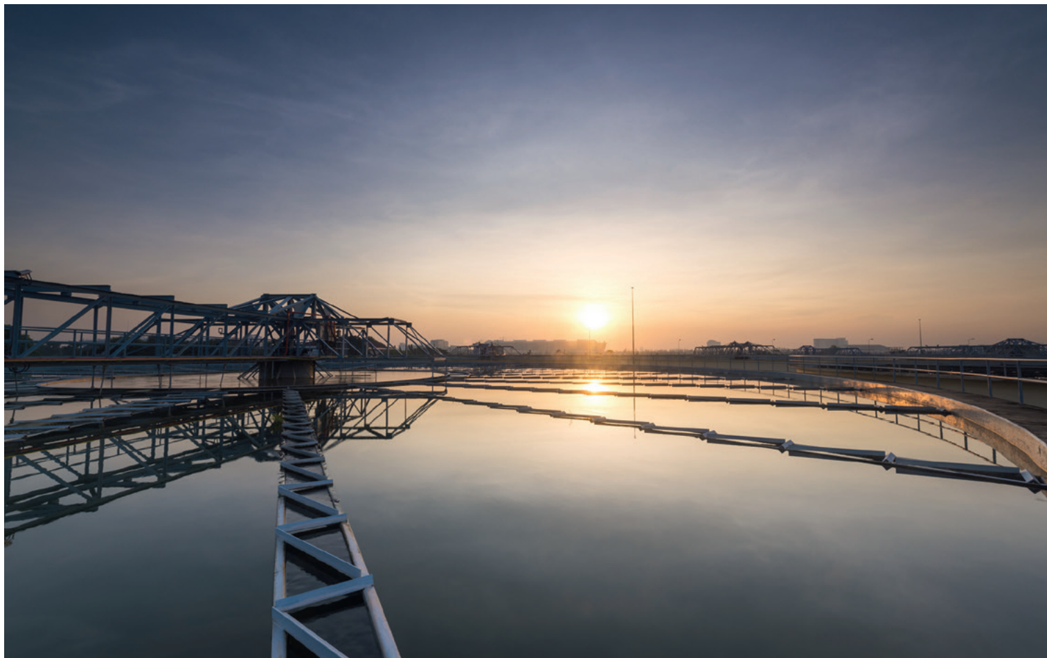
La station de traitement des eaux d'Ashford (près de Londres) a choisi un moteur à bride haute performance WEG HGF de 600 kW, 415 V, à 10 pôles.
