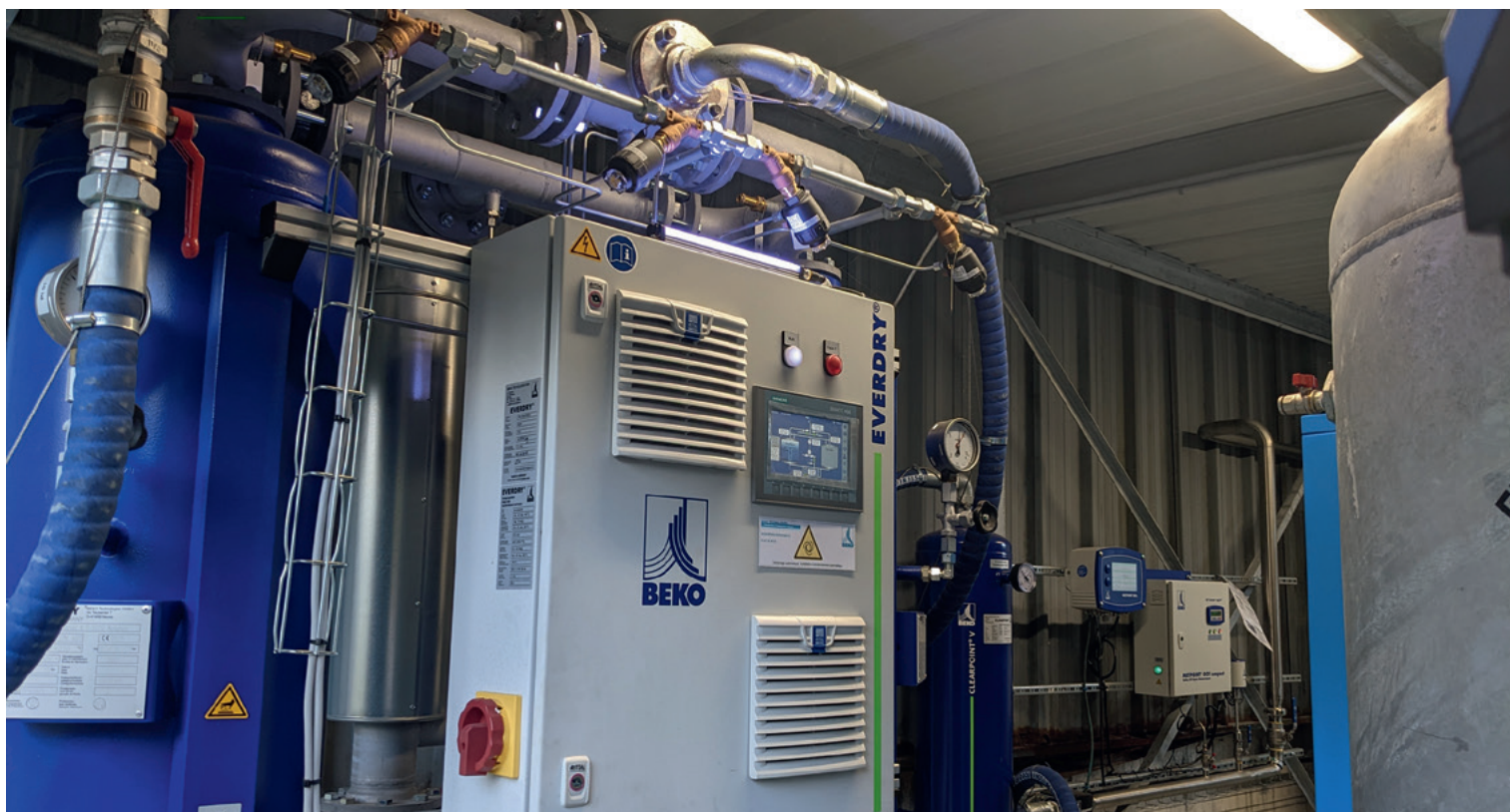
Un local annexe au site de production a été spécialement construit pour la nouvelle installation d'air comprimé.
