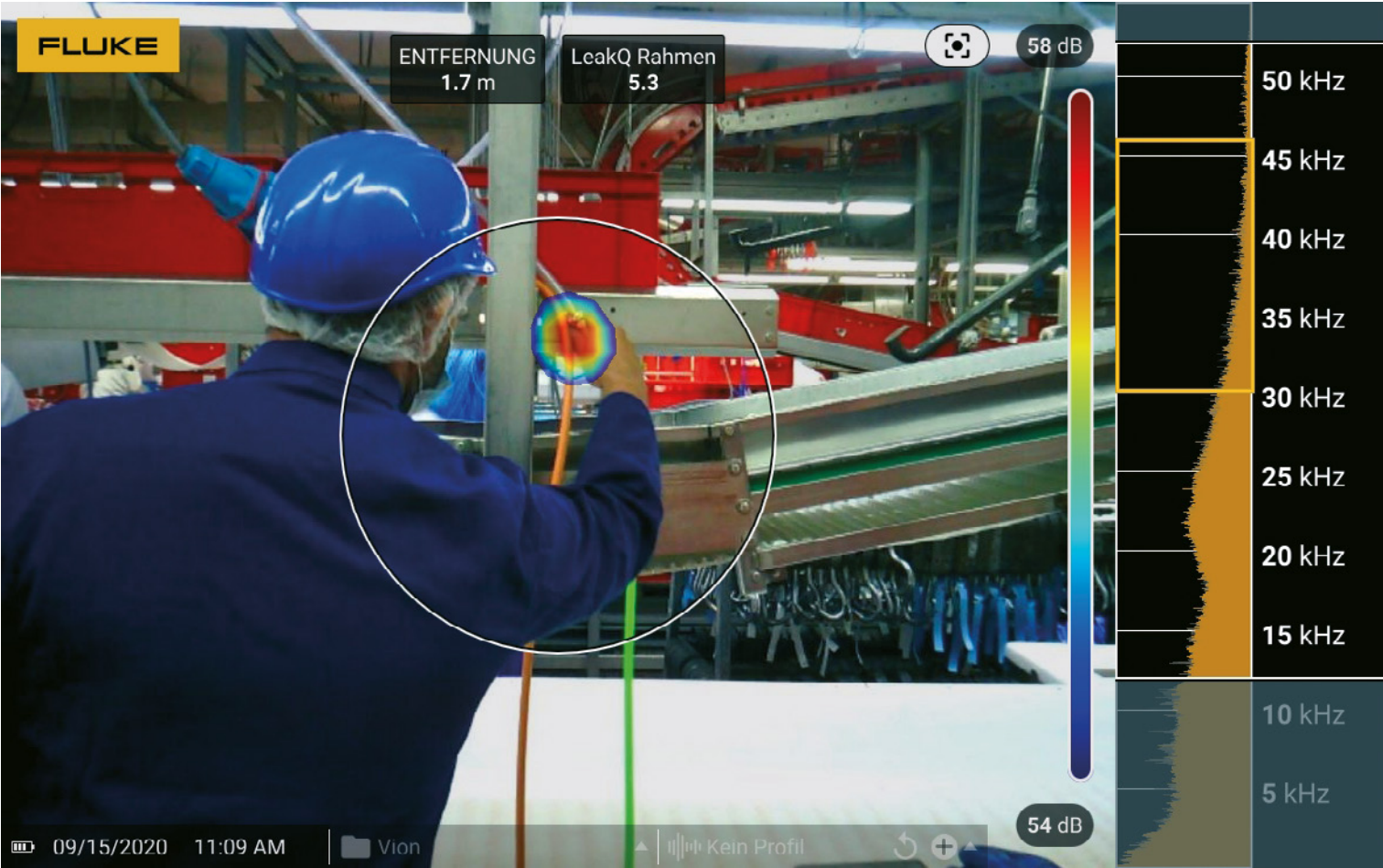
L'usine agroalimentaire allemande a commencé à utiliser le Fluke ii900 pour localiser les fuites d'air comprimé.
